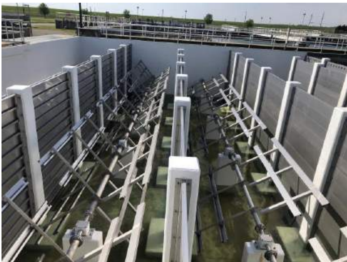
Foto 13.2: Sistema floculadores a paletas horizontales con baffles
