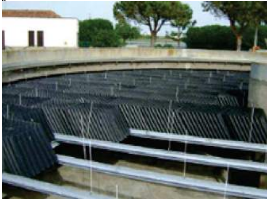
Foto 13.4: Vista clarificador circular con seditubos
